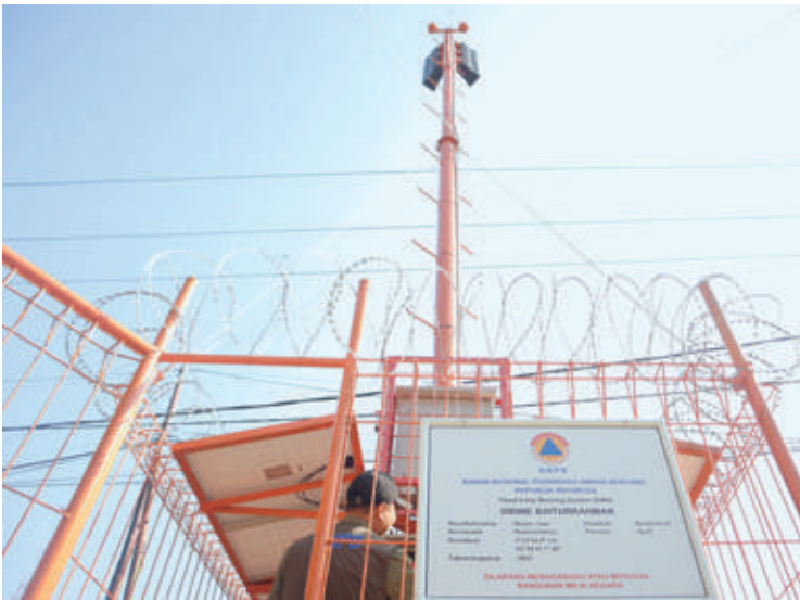
▲ Petugas melakukan pengecekan pada panel kontrol Sirine Flood Early Warning System (EWS) Baiturrahman milik BNPB, yang berlokasi di area Kantor Kecamatan Baiturrahman, Kota Banda Aceh, Minggu (26/4). Sumber foto : BNPB
