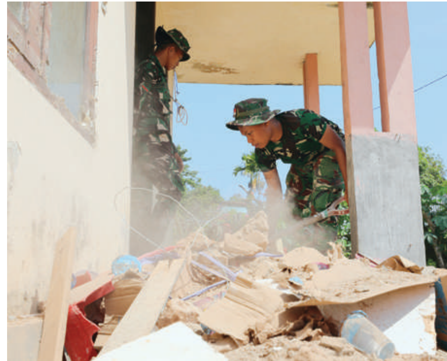
◀ Para personel TNI di tengah reruntuhan rumah warga. Pembersihan material rumah rusak dilakukan secara bergotong royong sehingga pemulihan dapat berjalan secepat mungkin pascagempa. Sumber foto : BPBD
