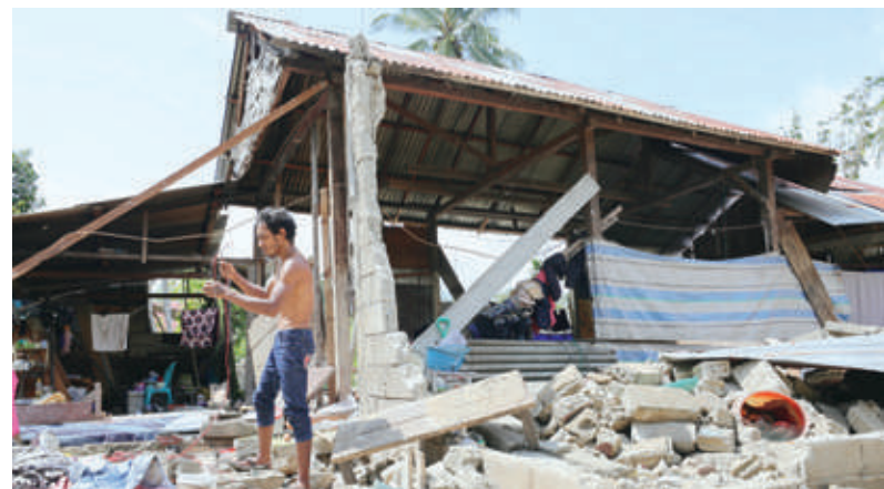
◀ Dinding rumah warga roboh pascagempa M6,7 Sulawesi Tengah. Warga terdampak pun memilih untuk mengungsi di sekitar rumah mereka. Sumber foto : BPBD
